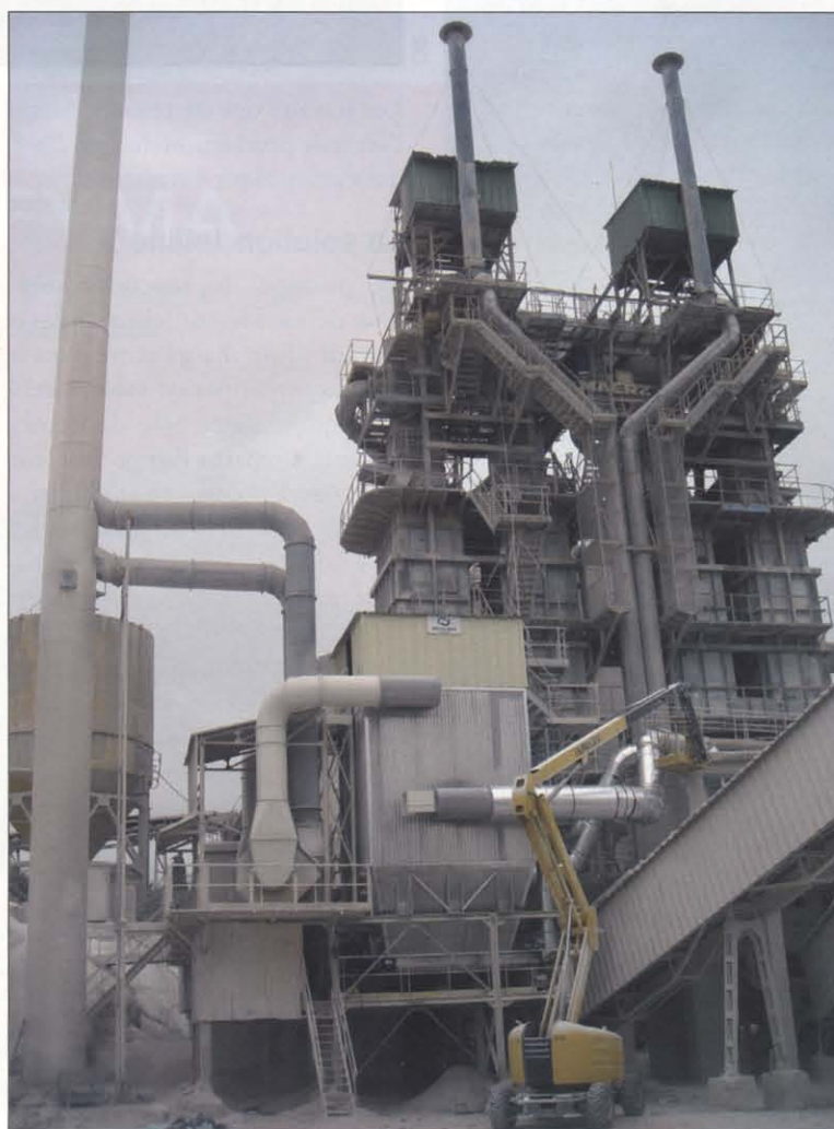
Installation de dépoussiérage Delta Neu chez Bocahut : l'ensemble de la chaudronnerie est en acier inoxydable. Elle est équipée d'un système de traçage et d'un système de calorifugeage
