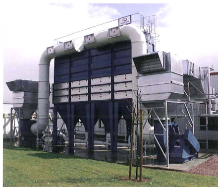
▲ La centrale d'aspiration Delta Neu à recyclage d'air avec deux ventilateurs et quatre séparateurs
